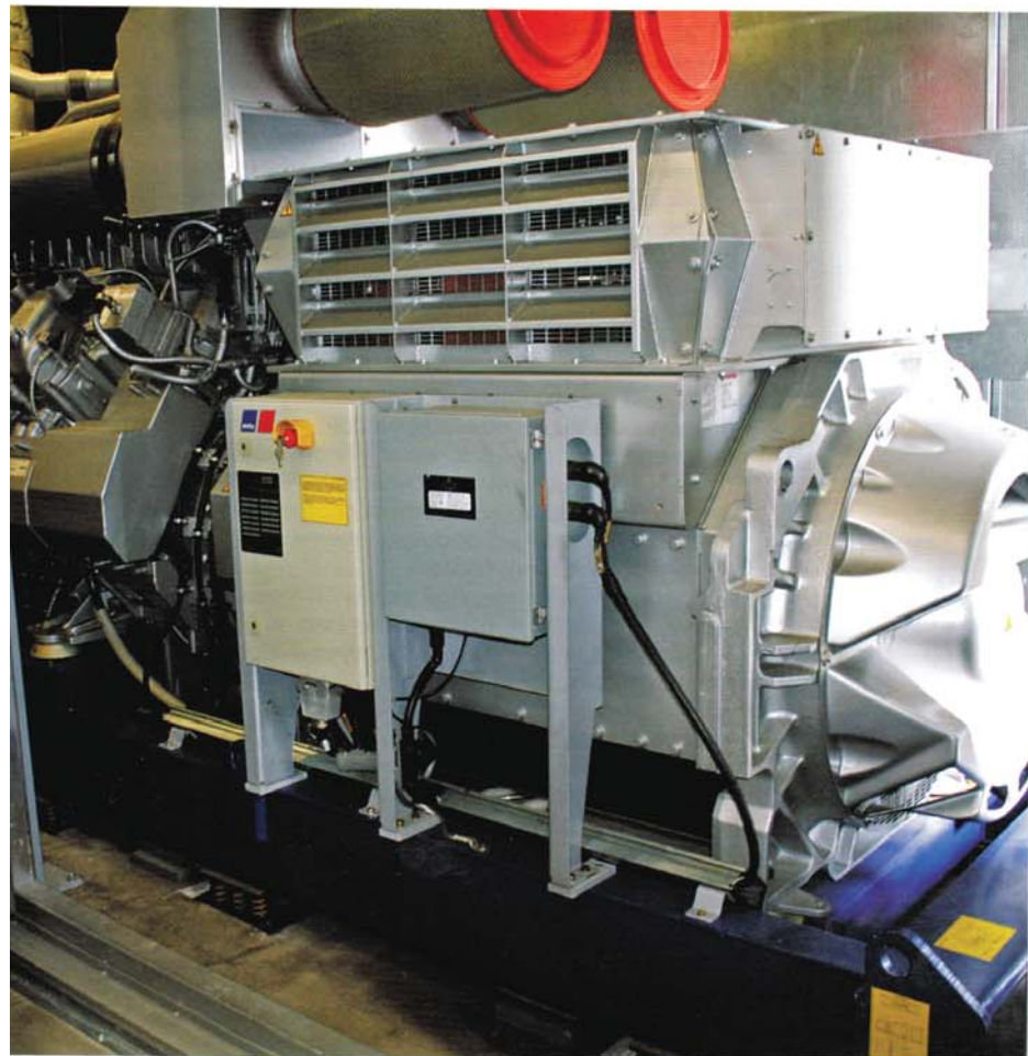
Виброизоляция дизель-генераторной электростанции
