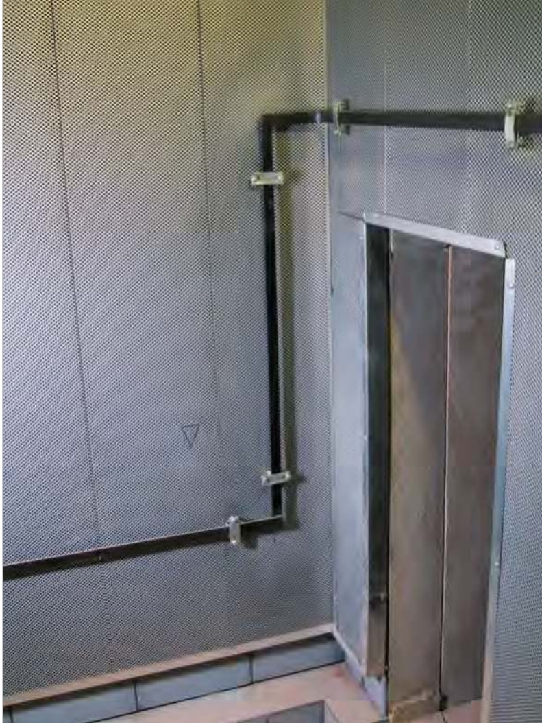
ЖК «Снегири» (техническое помещение), г. Москва
